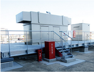
瑞穂区役所非常用発電機
